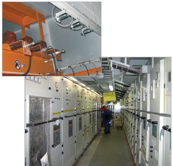
Typische Messorte an Kontaktstellen; mit stationären Pyrometern ausgestattete Mittelspannungsanlage
