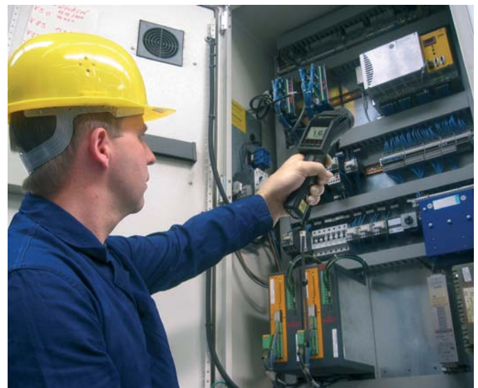
Abb. 1: Detaillierte Temperaturmessung an einem elektrischen Schaltschrank mit Hilfe des optris LaserSight LS
