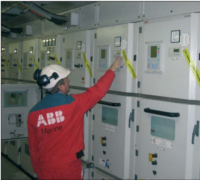
Abb. 2: Mit stationären Pyrometern ausgestattete Mittelspannungsanlage
